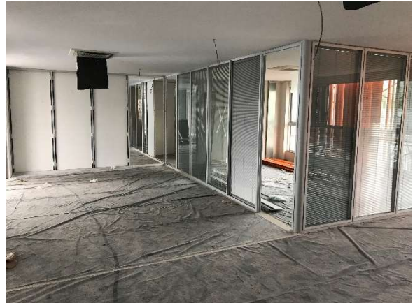
08 – Divisórias internas “cegas” e de vidro com persiana, forro e aparelhos de ar condicionado.
