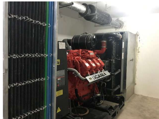
10 – Ligação do gerador.
